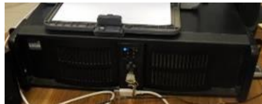
CPU CON SOFTWARE SCADA INSTALADO
